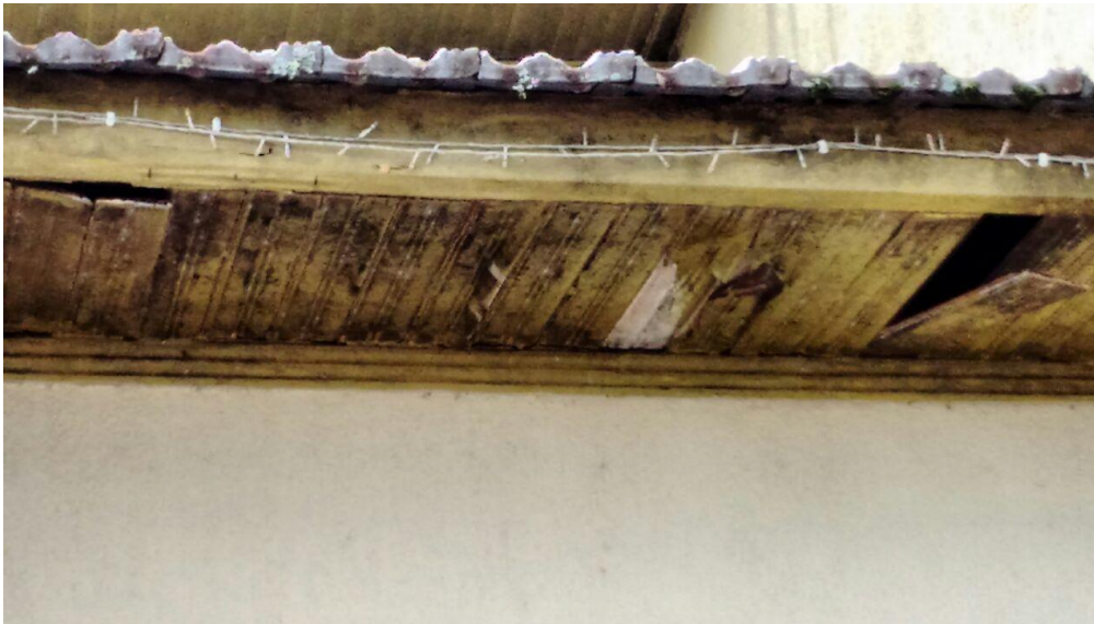
FOTO 01- BEIRAIS EM PÉSSIMAS CONDIÇÕES
