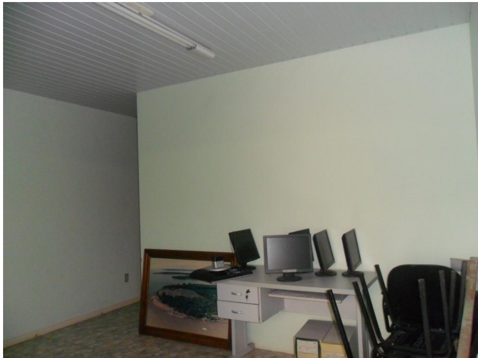
FOTO 07- ÁREA INTERNA: PAREDES QUE DEVERÃO SER DEMOLIDAS PARA NOVAS SALAS NO SETOR ADMINISTRATIVO DO LEGISLATIVO.
