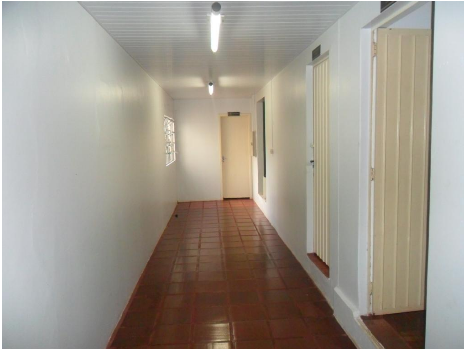
FOTO 06- ÁREA INTERNA: SANITÁRIO AOS FUNDOS À REFORMAR E PISO A SUBSTITUIR, FORRO EM BOAS CONDIÇÕES SOMENTE NÁ ÁREA DE CIRCULAÇÃO ÀS SALAS NOVAS.
