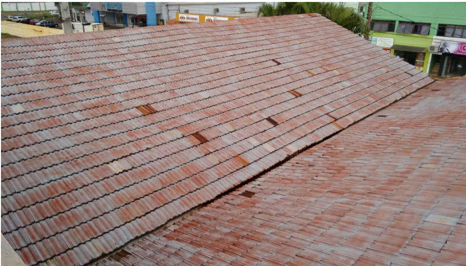
FOTO 03- COBERTURA E CALHA CAUSADORA DAS PATOLOGICAS/INFILTRAÇÕES
