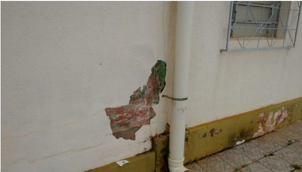
FOTO 02- REVETIMENTO EXTERNO E PINTURA DANIFICADOS
