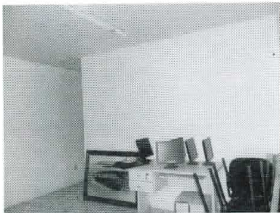
FOTO 07- ÁREA INTERNA: PAREDES QUE DEVERÃO SER DEMOLIDAS PARA NOVAS SALAS NO SETOR ADMINISTRATIVO DO LEGISLATIVO.
